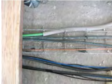
Aprovechamiento del plenum como conducto de ventilación
